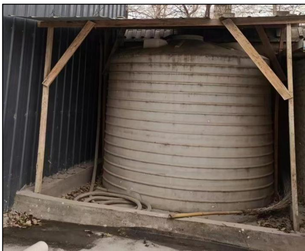
事故罐及围堰
